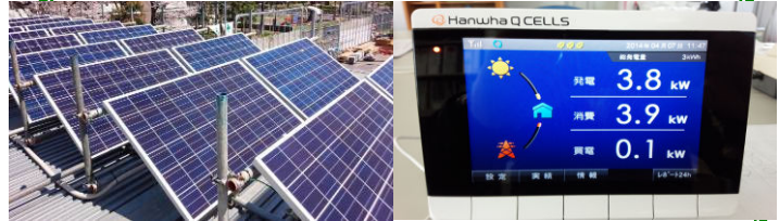
4kWクラス系統連系型 東京都足立区
